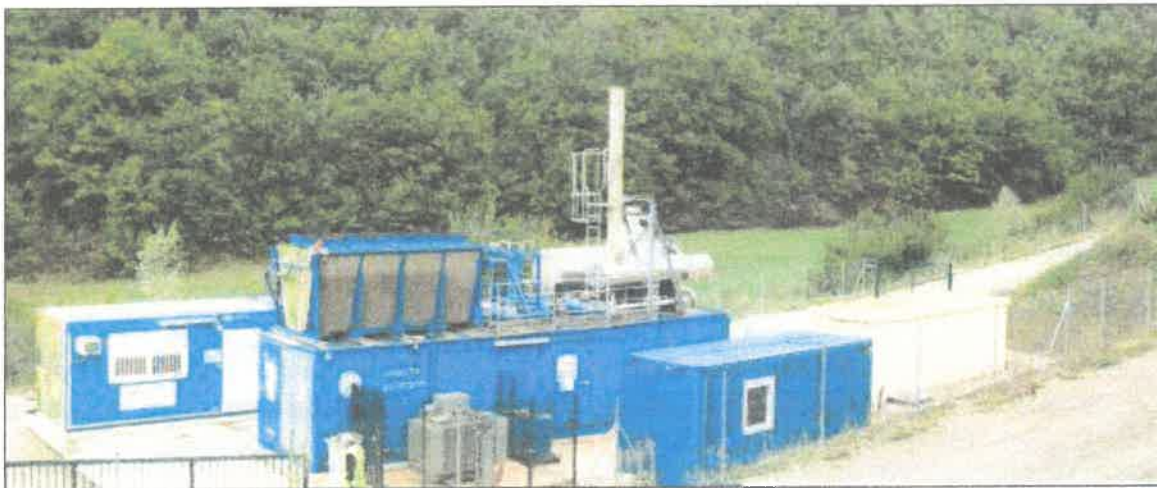
Centrale de valorisation électrique
